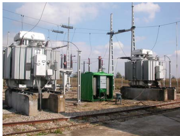
Figura 3. Instalația VIMAP R2000 în funcțiune
